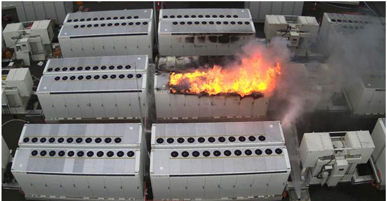
Incendio de un sistema público de acumulación de energía.
